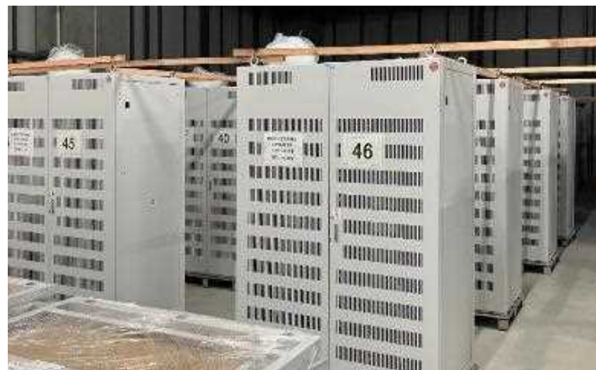
仮置き中の蓄電池
