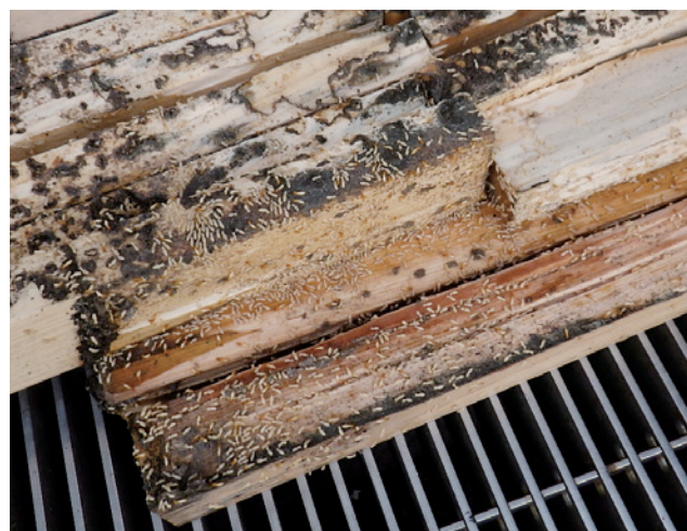
写真6 イエシロアリによる建築用資材の被害
